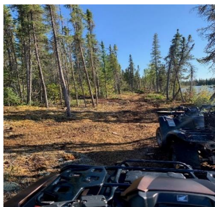
Construction en cours d'un sentier d'accès communautaire de 2,5 km pour VTT, motoneiges et randonneurs de Whati au lac La Marte.
