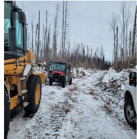
Construction en cours sur un tronçon du sentier du camp culturel et communautaire, à Kakisa.
