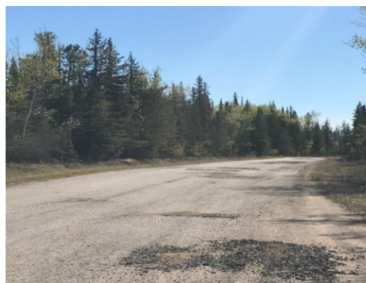
Section de la route d'accès au club de golf et au club de ski de Hay River désignée pour être resurfagée.
