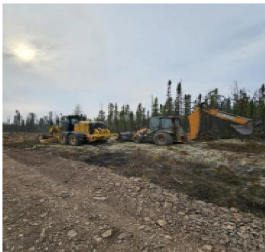
Poursuite des travaux de construction de la route d'accès au lac Austin à Łutselk'e, à l'été 2023.
