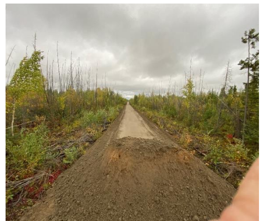
Poursuite des travaux de construction du sentier de promenade et de VTT du ruisseau Four Mile à Tulita (été 2023).
